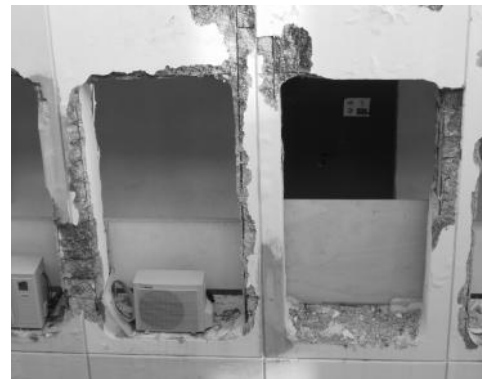
... rien pour le bâtiment qui s'effondre !
